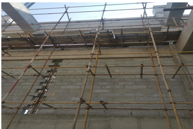
图 1 事故现场照片
